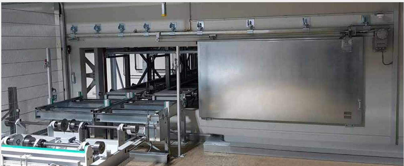
Abschottung eines Hochregallagers
