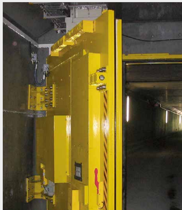
Air lock door
