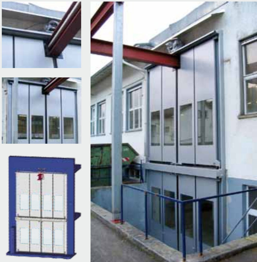
Pfefferle Hatek|Pfefferle Hatek|Pfefferle Hatek|Puerta con paso para puente-grúa en Pfefferle Hatek
